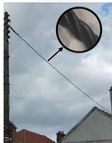
Réseau fils isolés aérien BT
