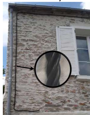
Réseau fils isolés façade BT
