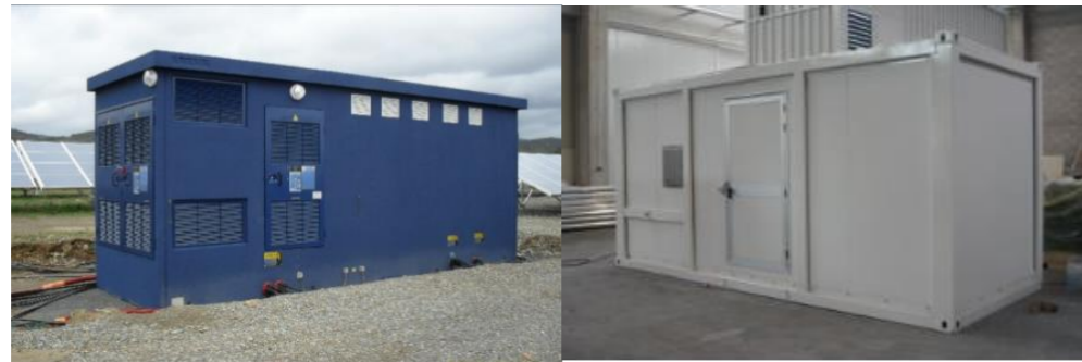
Figure 8 Exemples d'onduleurs et transformateur installés dans postes béton et containers
