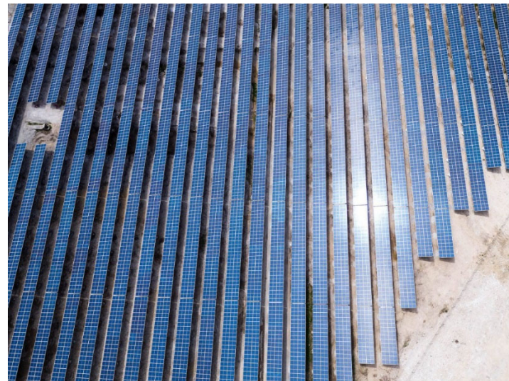
Modules photovoltaïques, convertissant l'énergie solaire en électricité – Q ENERGY France
