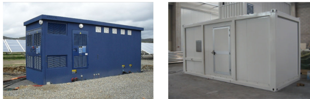
Exemples d'onduleurs et transformateur installés dans postes béton et containers – Q ENERGY France
