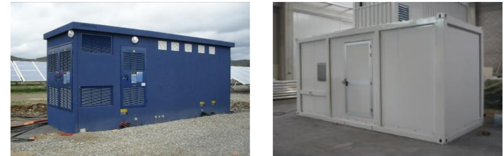
Exemples d'onduleurs et transformateur installés dans postes béton et containers
