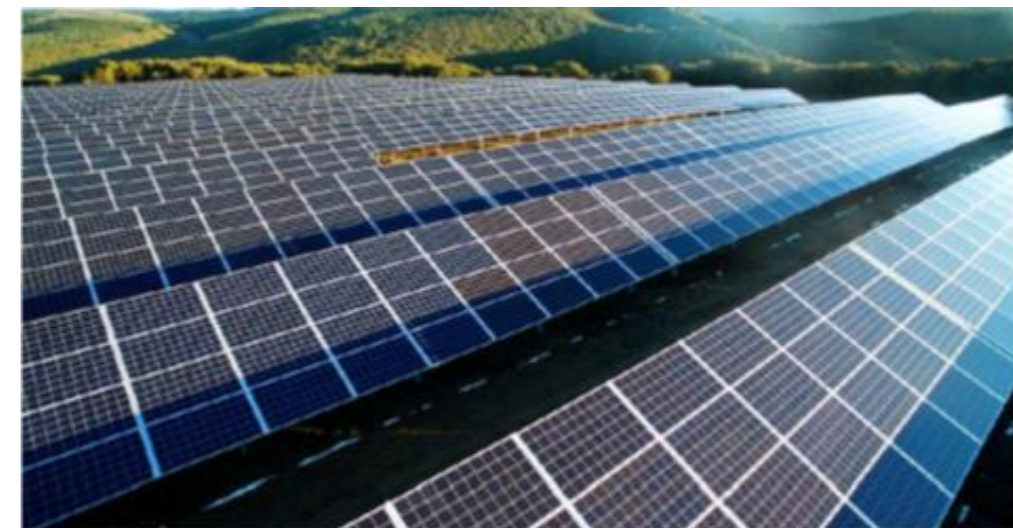
Exemple de structure fixe – Q ENERGY France
