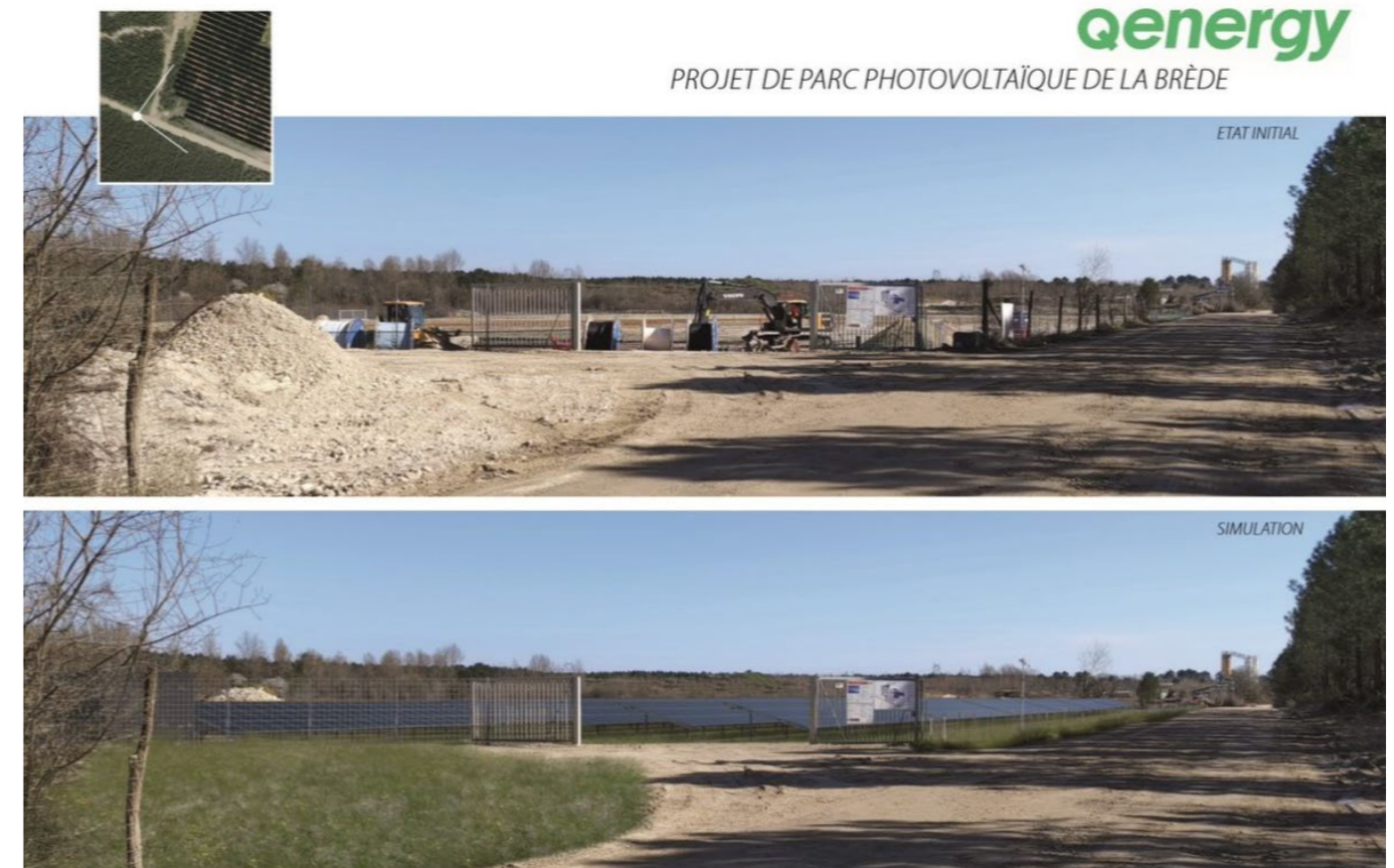
Figure 8 : Le projet solaire La Brède, en construction dans la commune de La Brède - Q ENERGY France
