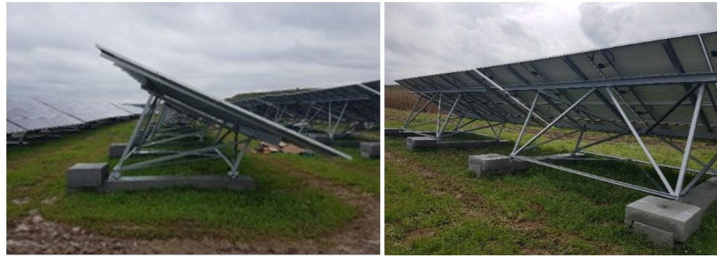
Photographie 4 : Exemple de fondations béton - Q ENERGY France
