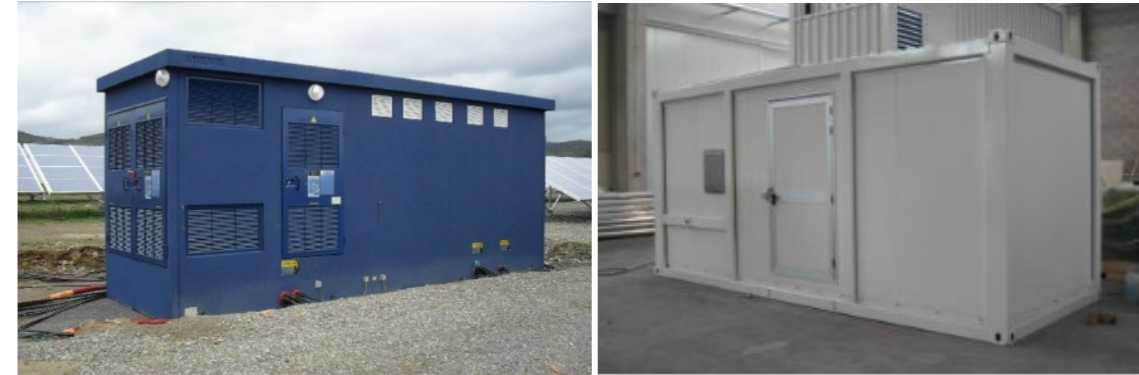
Photographie 5: Exemples d'onduleurs et transformateur installés dans postes béton et containers
