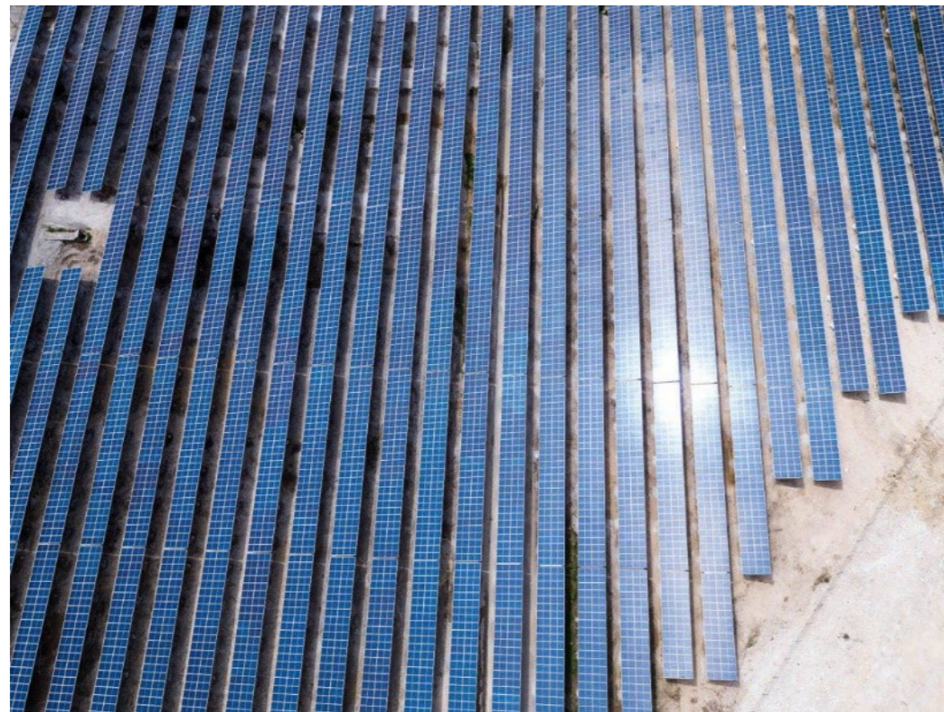
Photographie 1 : Modules photovoltaïques, convertissant l'énergie solaire en électricité - Q ENERGY France
