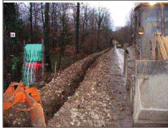
Les câbles électriques de raccordement sont enterrés le long du réseau public existant à l'aide d'une trancheuse.
