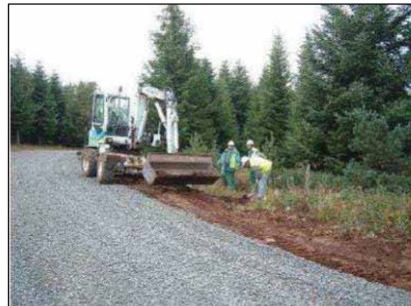
Les câbles électriques de raccordement entre la structure de livraison de la centrale solaire et le poste source ou le point de connexion sont enterrés.
