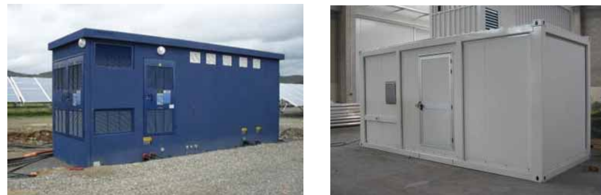
Photographie 77. Exemples d'onduleurs et transformateur installés dans des postes béton et containers
