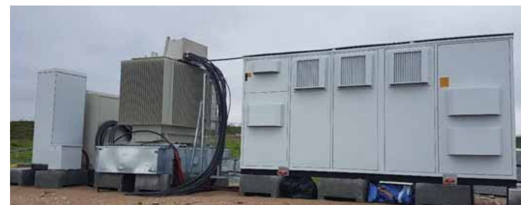
Photographie 79. Exemple d'onduleurs et transformateur installés à l'extérieur
