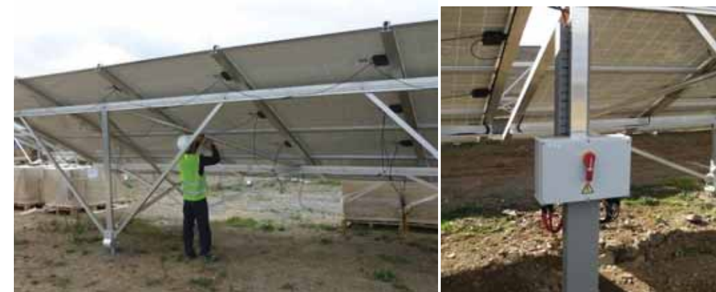
Photographie 88. À gauche : Câblage des panneaux - A droite : Boîtier de raccordement - RES
