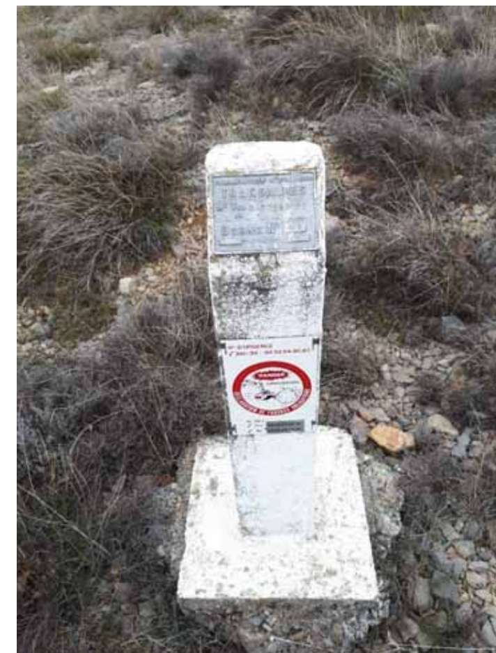
Photographie 14. Borne de localisation de la canalisation
