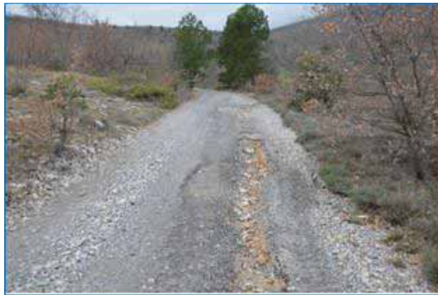
Photographie 26. Phénomène d'érosion sur le chemin d'accès à la station de pompage
